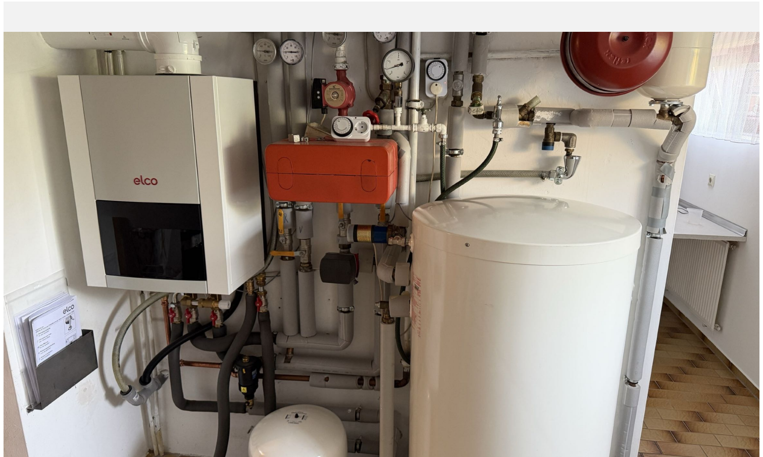
Gas-Brennwerttherme mit Warmwasserspeicher
